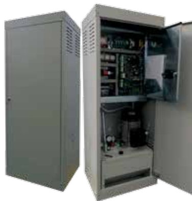
Armadio centralina e quadro manovra
