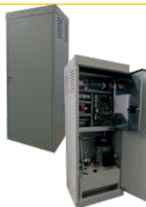
Armadio centralina e quadro manovra
