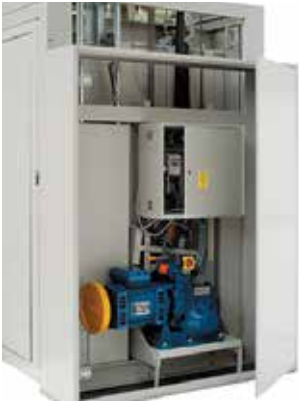
Argano e quadro manovra posizionati al piano basso e collegati alla struttura portante (riposizionamento ad altri piani opz.)
