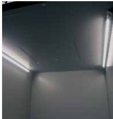
Illuminazione Cabina con luci LED
